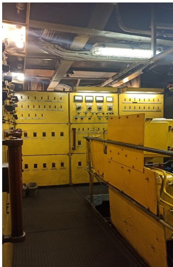
Рисунок 2.2 Главный распределительный щит
