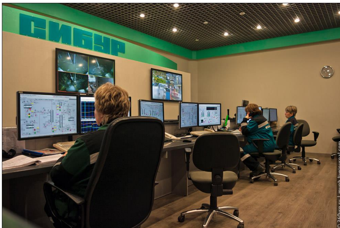
Центральный пункт управления
