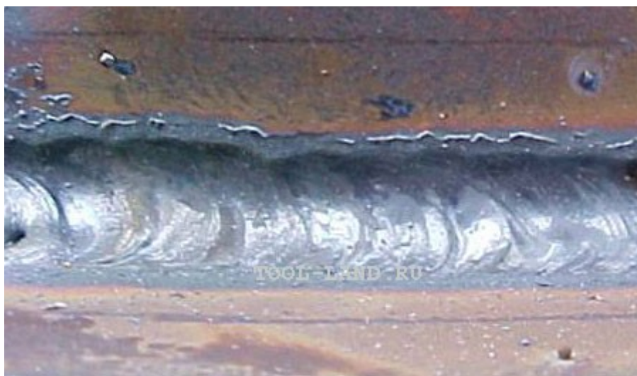
Дефекты сварного шва: подрезы
