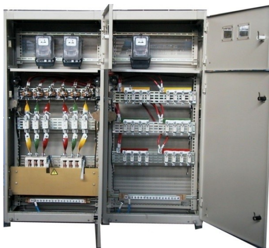
Фото 3 — Разделительные панели вводно-распределительного устройства
